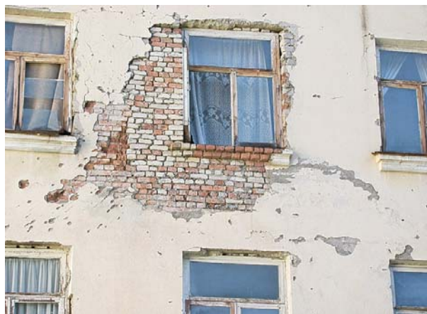
Здание больницы после войны. Хорошо видны следы пуль (фото из архива)
